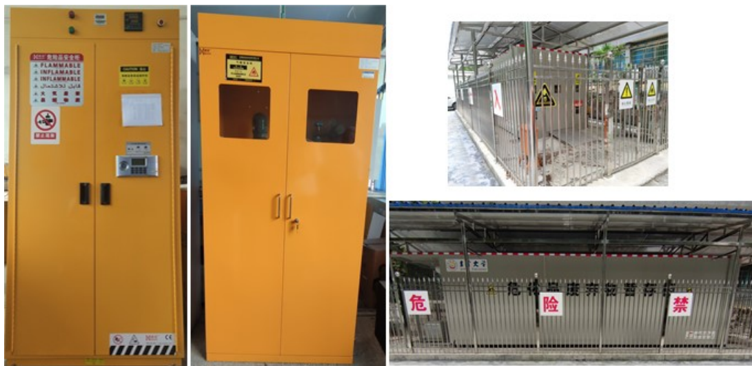
危化品储存柜、气瓶防爆装置、废液处置集装箱
